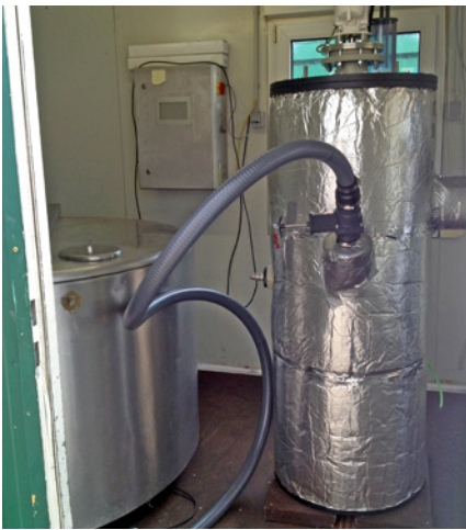
Bild 4: H 2 -Fermentation Technikumsanlage RSA OptFuel
